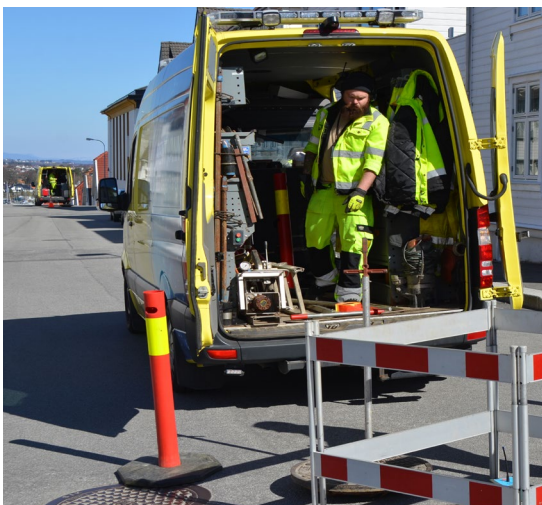
Lyttepunktene plasseres med ca 150 meters mellomrom, her markert ved de to kjøretøyer.
